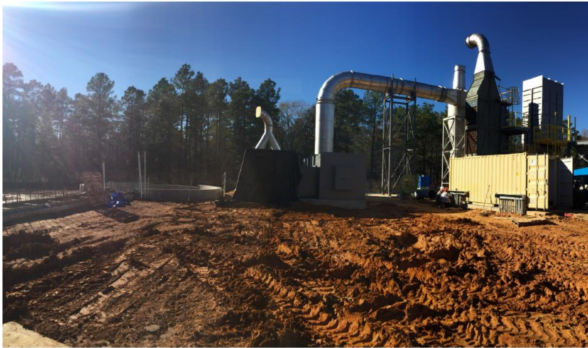
PAS Installation – Area
